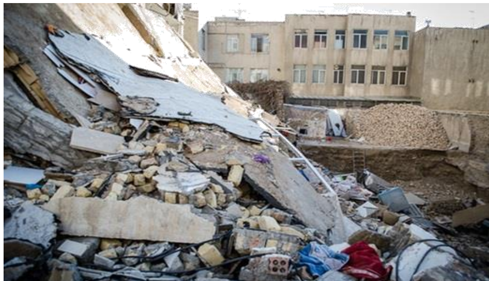
شکل ۶-۲. تصویری از ریزش ساختمان مسکونی مجاور گود در منطقه شهران تهران
