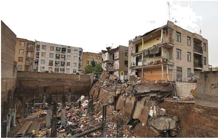
شکل ۶-۴. تصویری از ریزش ساختمان مسکونی در بلوار فردوس تهران
