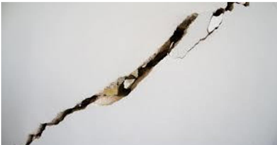
شکل ۶-۷. تصویری از ترک ایجاد شده روی دیوار
