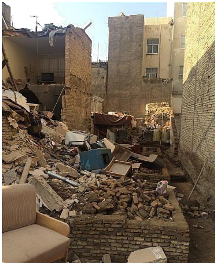
شکل ۶-۶. تصویری از ریزش ساختمان مسکونی در منطقه مشیریه تهران
