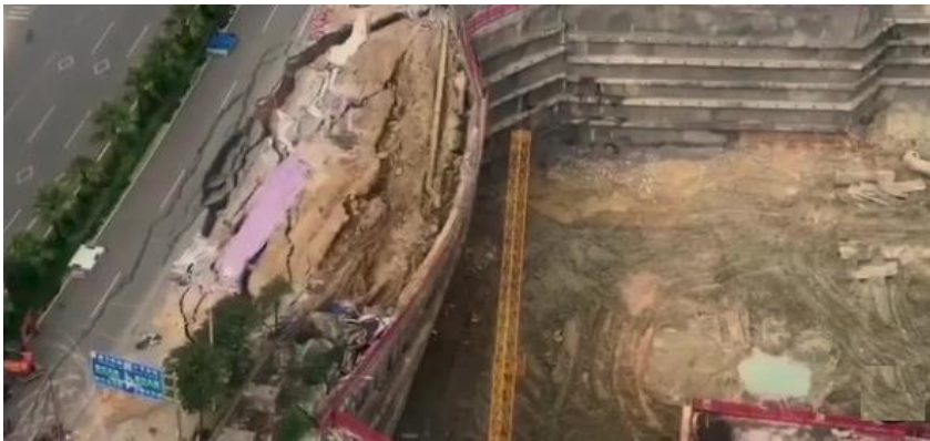
شکل ۱-۱۲. تغییر شکل قابل توجه دیواره گود ناشی از بار زلزله
