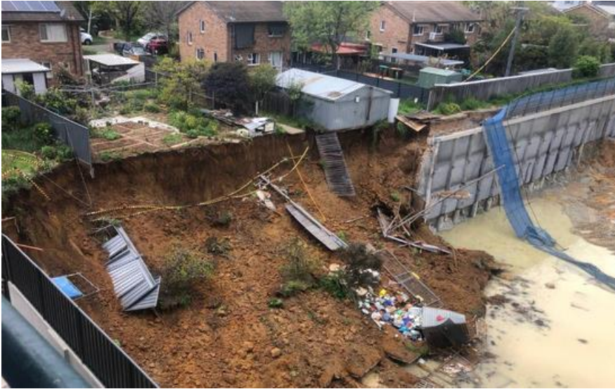
عکس ۱-۱۵. خسارتهای مالی شدید ناشی از ریزش گود
